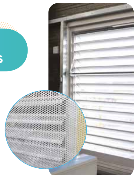
(Vue intérieure et extérieure ouvrant de façade équipé d'une grille anti-nuisible)
