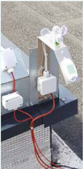
(Luxmètre extérieur avec sonde de pluie et vent)
