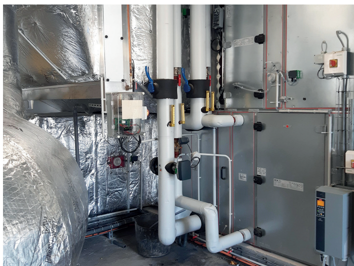
Installation adiabatique GRDF
