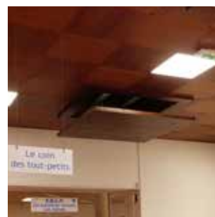
Diffuseur faux plafond
